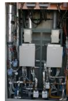
住戸内給湯機器
