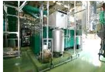
木質バイオマスプラントシステム
