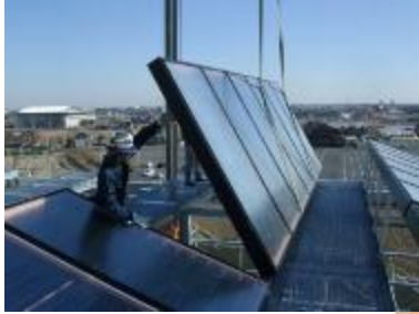
太陽熱パネル 250㎡ ≒122KW
