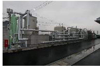
地下水ろ過装置 処理能力：100 m 3 /h
