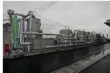
地下水ろ過装置 処理能力：100 m 3 /h
