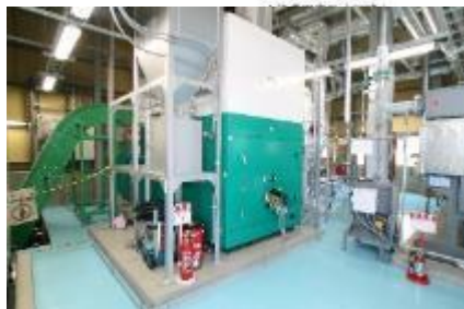
バイオマスチップボイラー
