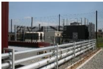
冷却塔、ヒートポンプチャラー
