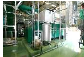
木質バイオマスプラントシステム
