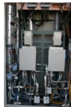
住戸内給湯機器
