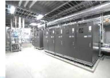
地下水利用空調システム
