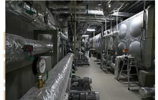
地下水蓄熱タンク類
