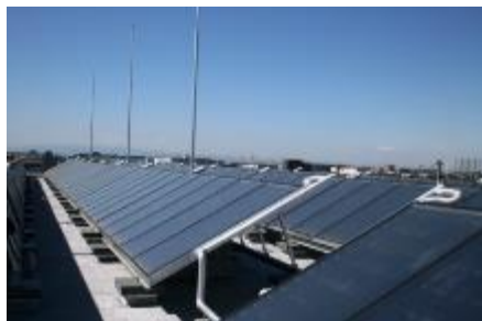
太陽熱集熱パネル ≒1000㎡
