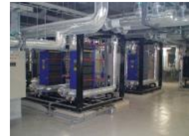
冷温水熱交換ユニット
